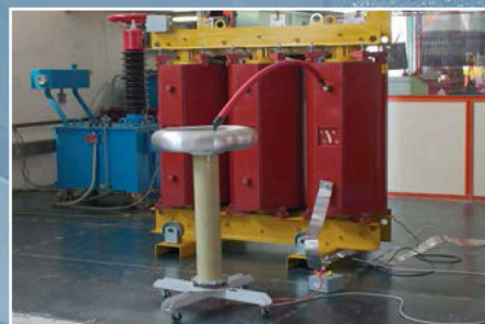
Misura di Scariche Parziali
