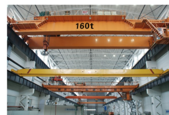
2台160吨双梁起重机 2 sets of 160 Ts double rails crane
