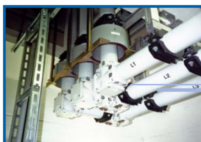
GL 12 kV – 2500 A
