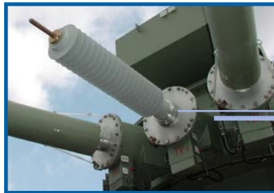
DTOI 123 kV – 1250 A
