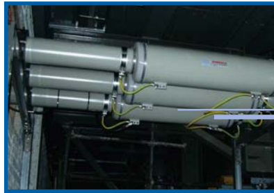
DG 17,5 kV – 2500 A
